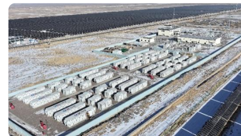
Gansu, China 60MW / 120MWh
